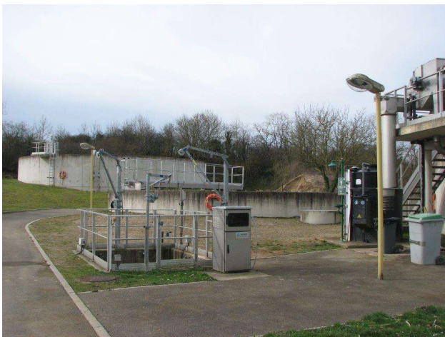
Station d'épuration de Saint Bris le Vineux (installation récente) ; source : Etude de préfiguration assainissement CA Auxerrois 2018
