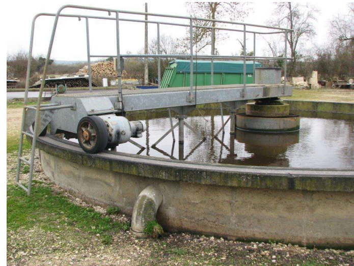
Exemple de station obsolète sur le département de l'Yonne ; source : Etude de préfiguration assainissement CA Auxerrois 2018
